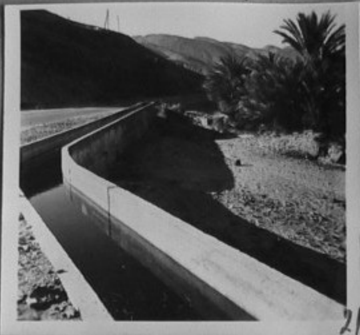
74-3403-21-ТЕС - напоителен канал по долината на р. Драа. /Г. Стоянов/ИК
