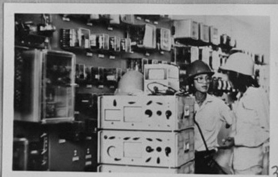
88-20-3-0 От декември 1987г. влезе в действие първия турбинен генератор на водно-електрическата централа в Три Ан, намираща се на 50 км северно от гр. Хо Ши Мин. /репр./ЛА
