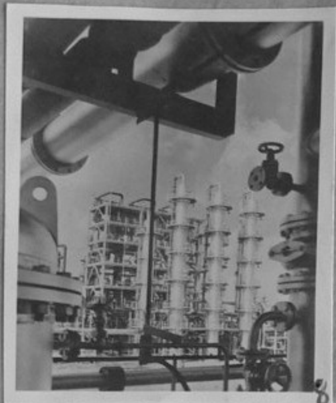
70-277-8-Нефтопреработвателна инсталация в една фабрика край Бриндизи /Апулия/. /репр./ИК
