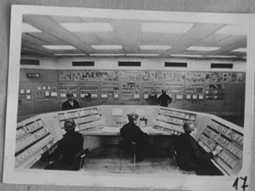
82-1460-17-Централния пулт за управление на цех № I-б за производство на синтетичен амоняк към Горловското производствено обединение. /репр./ЛА
