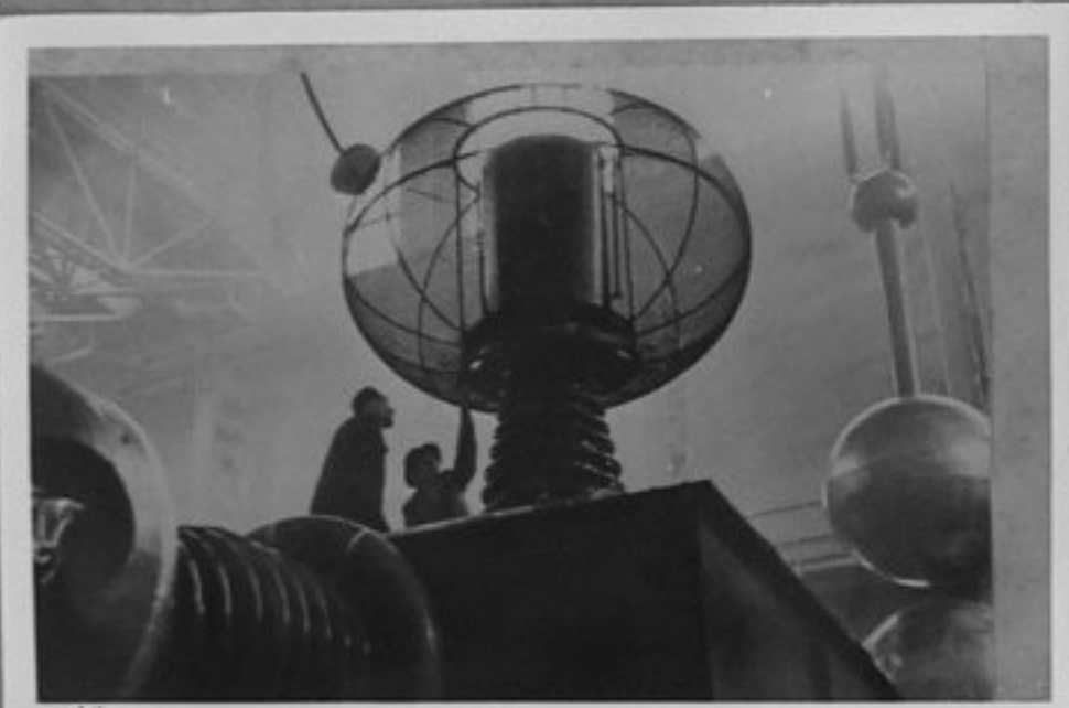
11-Част от масления каскаден трансформатор с мощност 2,250 киловата, произведен в Запорожкия трансформаторен завод.
