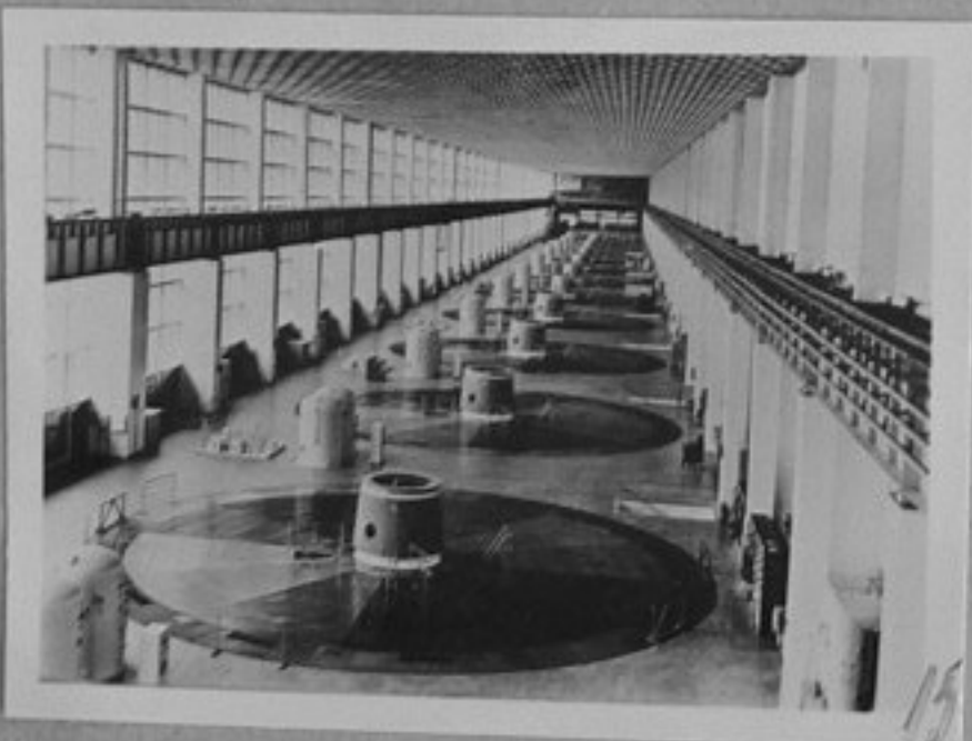
72-4805-15 - Машинната зала на Красноярската ВЕЦ.
