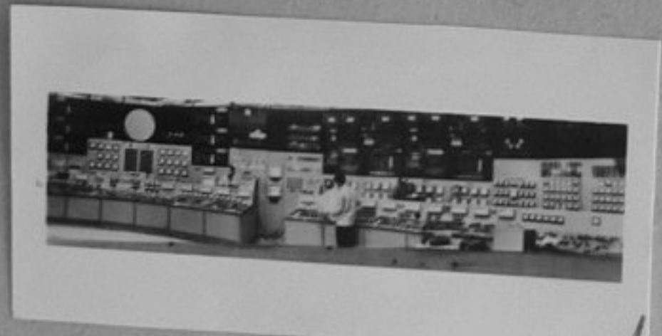
73-1712-1-Контролното табло на IV енергоблок /генератор/, който произвежда 440000 кв/ч електроенергия в Нововоронежката АЕЦ. /Репр.П.Щерев/МК
