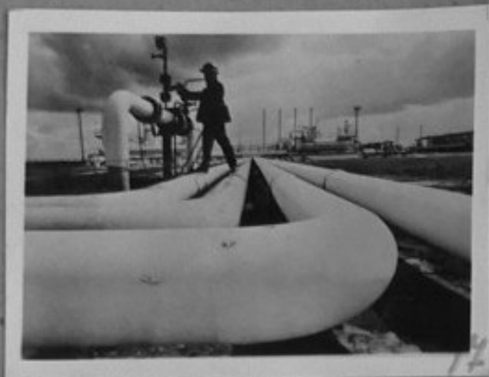
74-4719-17-Едно от трите съоръжения за комплексна подготовка на газ за транспортиране на газ по тръбопроводите към газопереработвателния завод. /репр. П. Щерев/ТК
