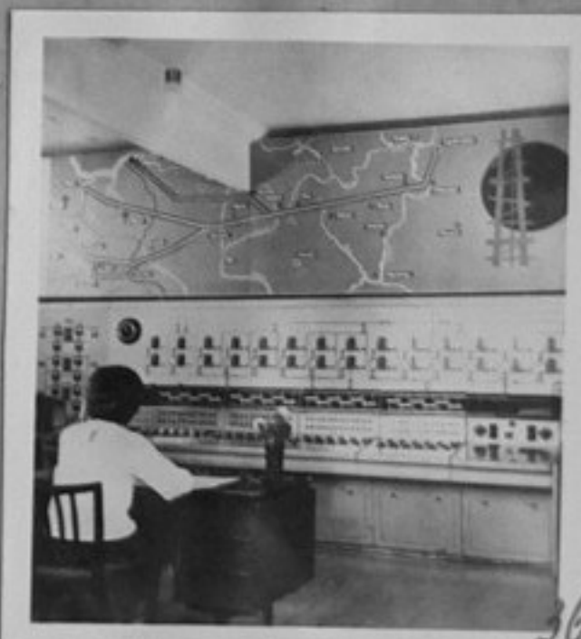
73-5745-36- Главни съоръжения на нефтопровода "Дружба". Общ изглед на централния пулт за управление на резервоарния парк, гр.Алматевск, Татарска АССР, РСФСР. /Репр. П.Щерев/СС
