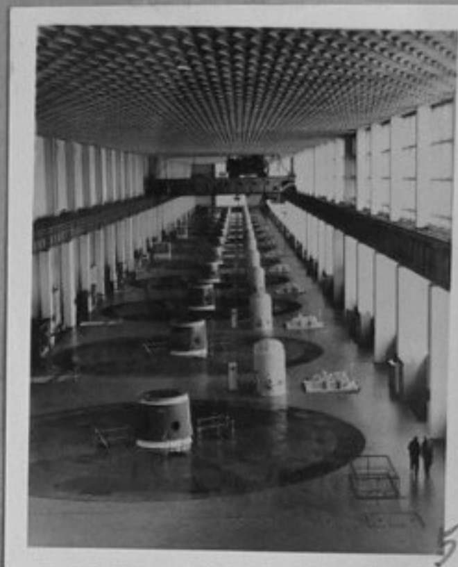
75-3570-5- Машинната зала на най-голямата в света хидроелектроцентрала на р. Енисей, Източен Сибир - Красноярската ВЕЦ. /репр./, ЗЩ
