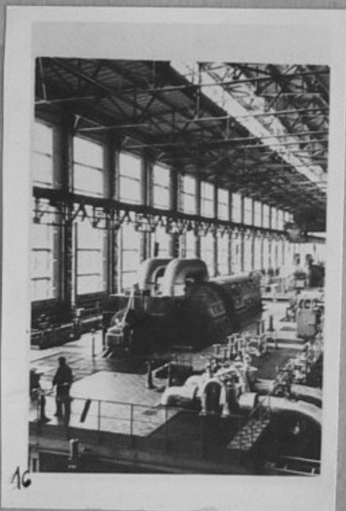
61/3770-16-Машинната зала на Приднестровската ТЕЦ в Украинската ССР.
