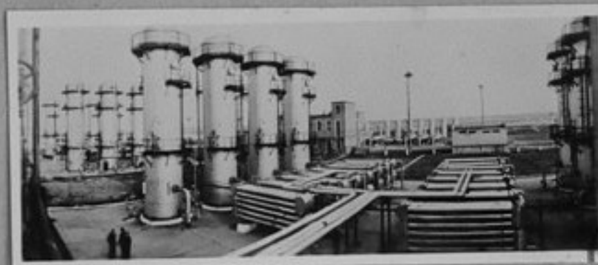
79-415-16-Главната компресорна станция на газопровода "Братство". /репр./ЛА
