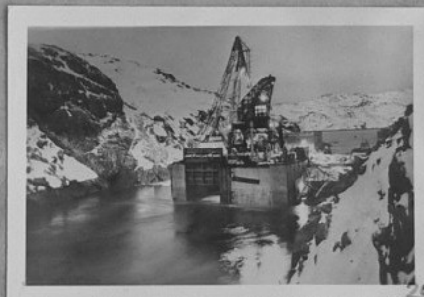
70-778-20-Изглед от Кислогубската електростанция на брега на Баренцово море. /репр.П.Щерев/ ИК
