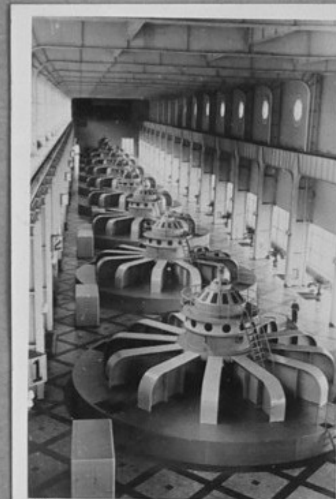
14-Общ изглед на машинната зала на Днепровската водноелектр. централа.
