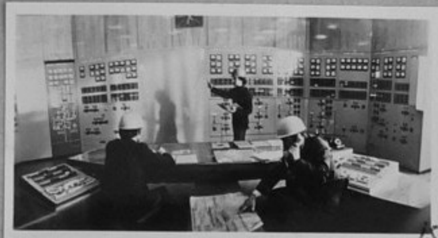
79-216-15 На главния пулт за управление на подстанцията "Западно-украински" по далекопровода за високо напрежение "Виница-Албертиша" репр./МД
