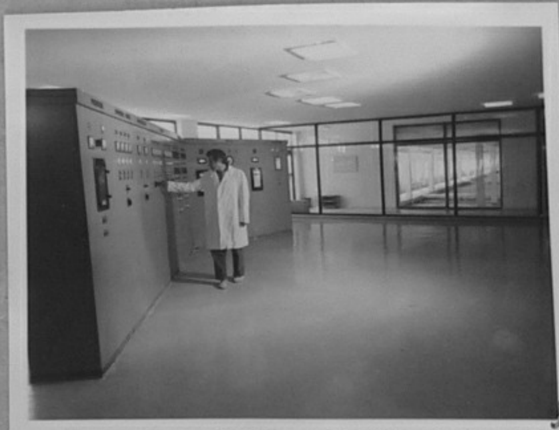
72-4389-5-Пречиствателната станция край Панчарево. /Е.Любомиров/ИК
