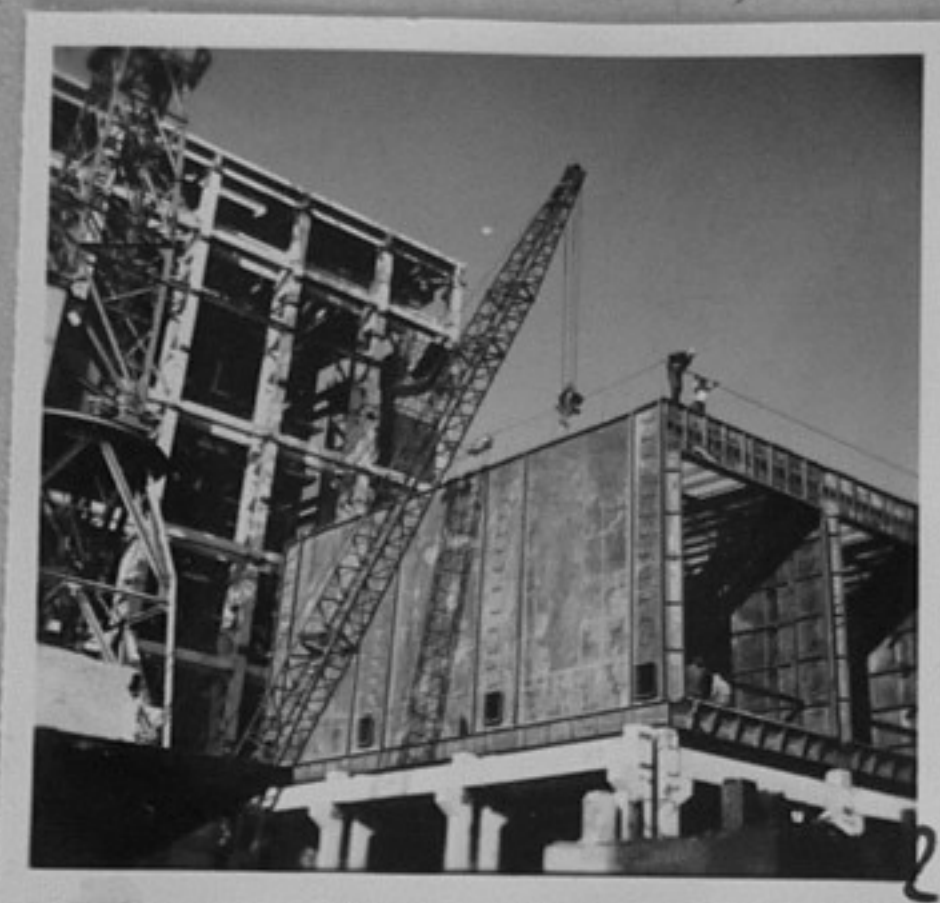
65/2258-2 - Електро-филтри в монтаж /Йорданов/ ЕИ
