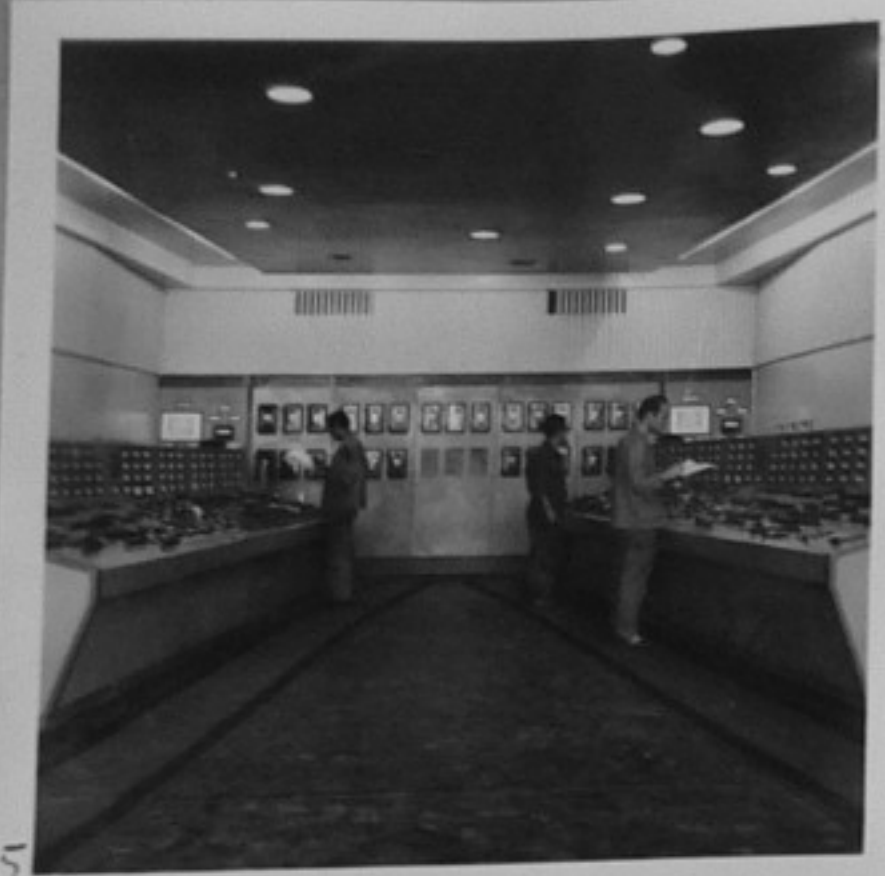
5-Общ изглед на топлинния щит.
