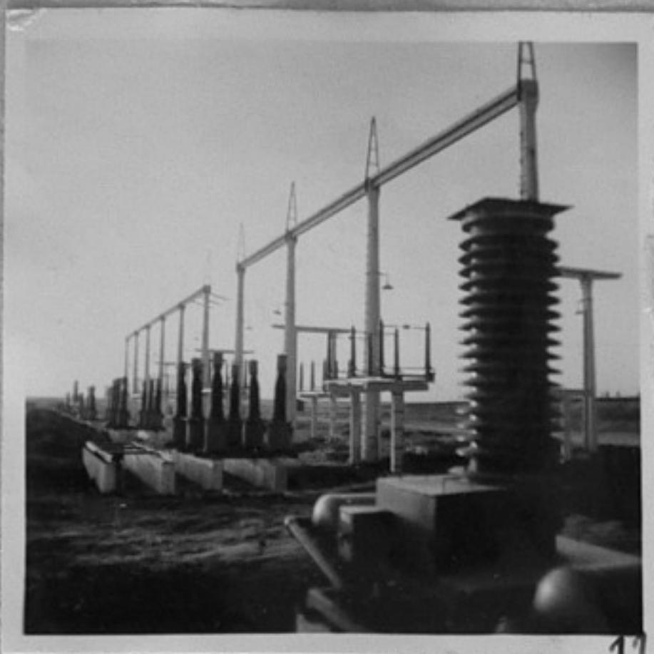
65-2259-11 - Трансформаторна подстанция към ТЕЦ. /Йорданов/ ЕИ
