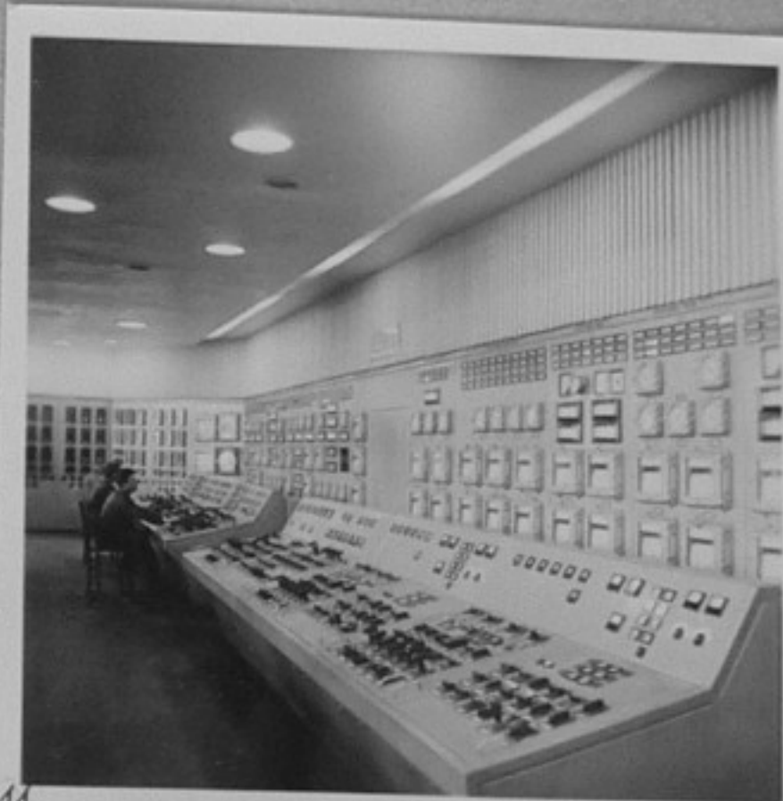
66/850-11-Командна зала на турбинния и котелен цех. /Парушев/ ММ
