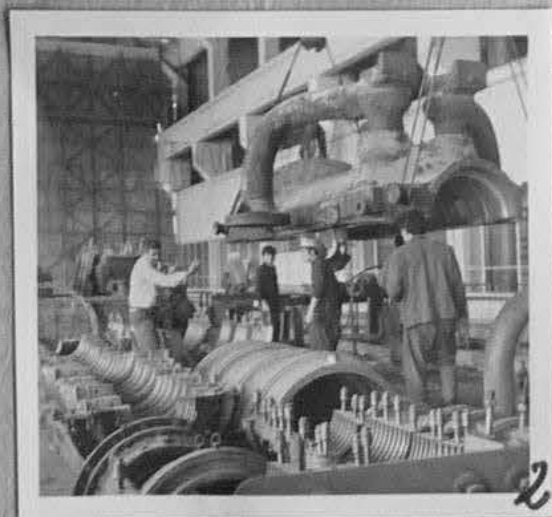
71-3498-2,4-ТЕЦ към завода.
