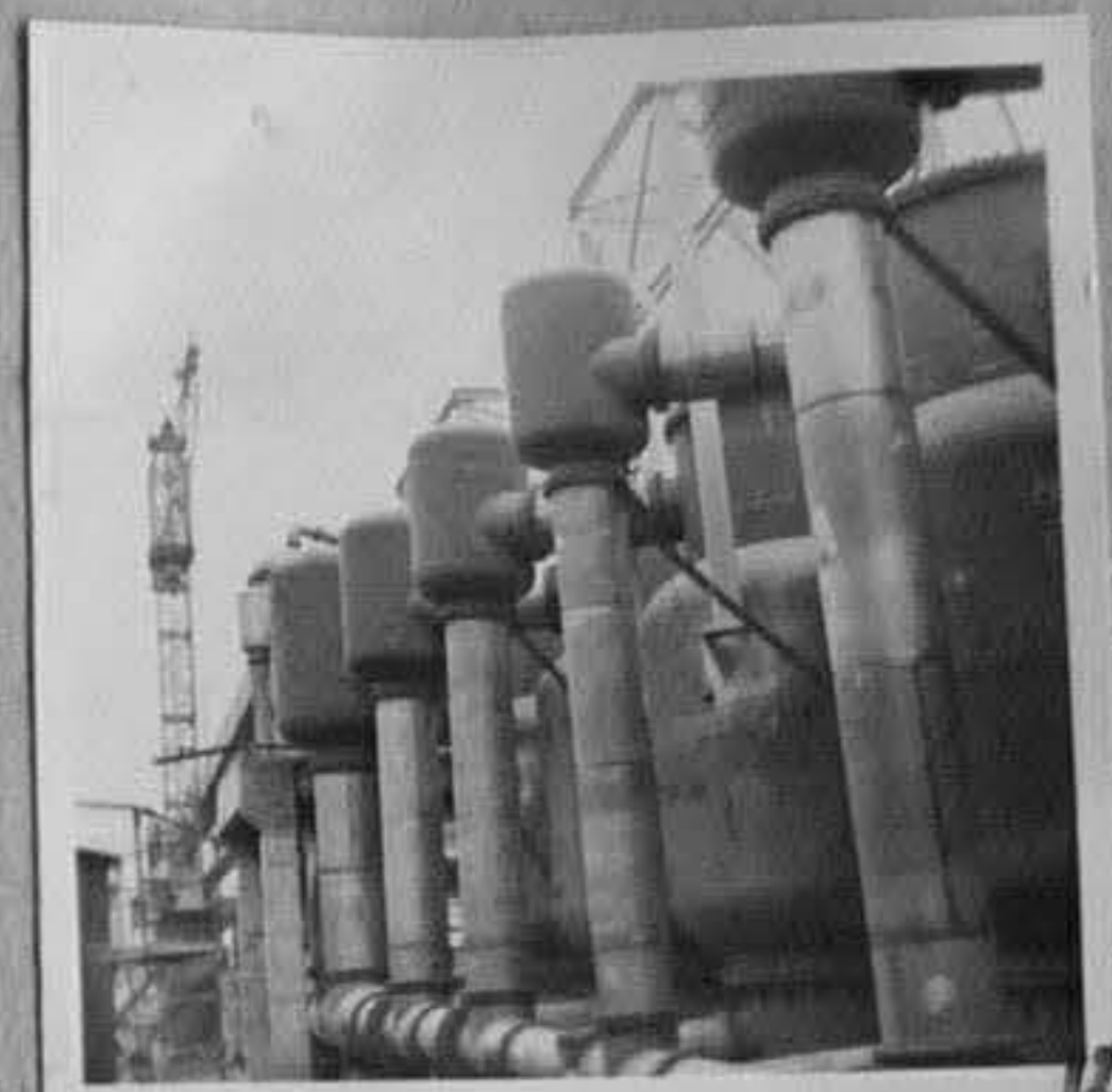
70-4729-12-Завод за ацетатни влакна - воден блок. /Л.Златков/ ХП
