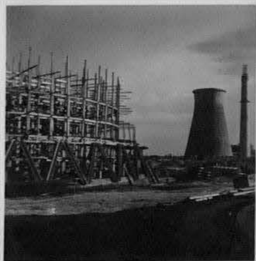
1-Охладителна кула - корпус 502.
