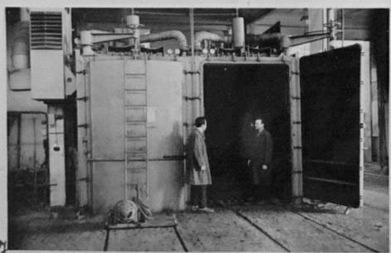
7-Вакум сушилна за изсушаване на трансформатори до 18000 KVU.
