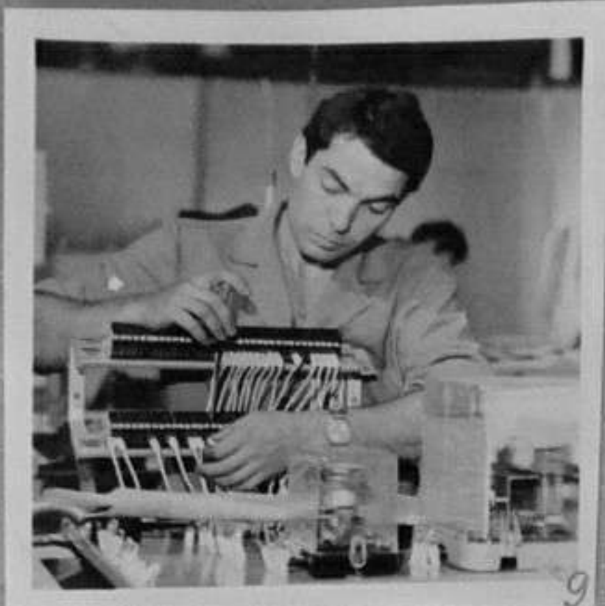
83-1424-9-Живко Стефанов, елмонтър, извършва вторична комутация на комплексно разпределително устройство. В.Балевска/ЛШ
