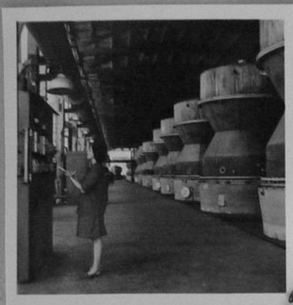
68-2484-6-Подстанцията към ТЕЦ "Марица-изток 2". /Хорисян/ ХП
