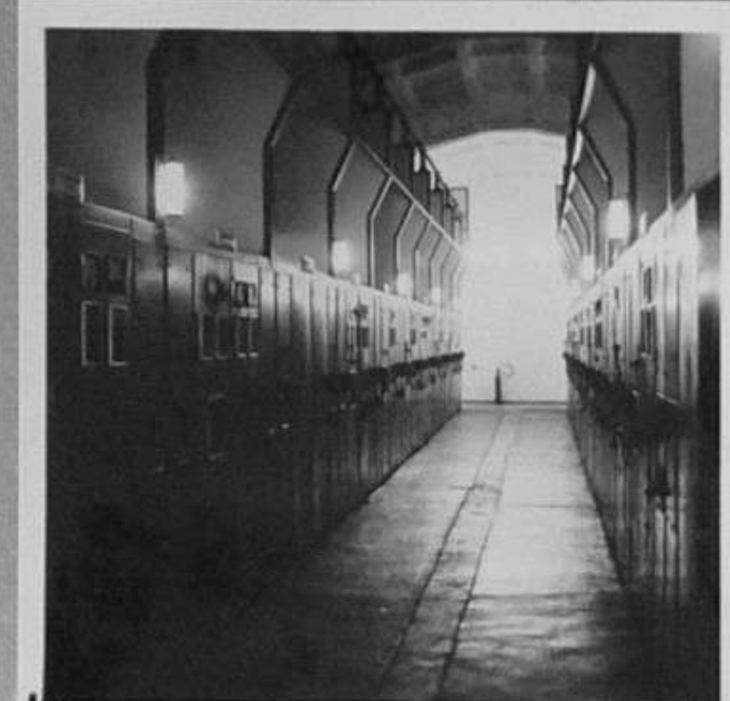
12-Подстанция Ямбол - уредбата 20 киловолта.
