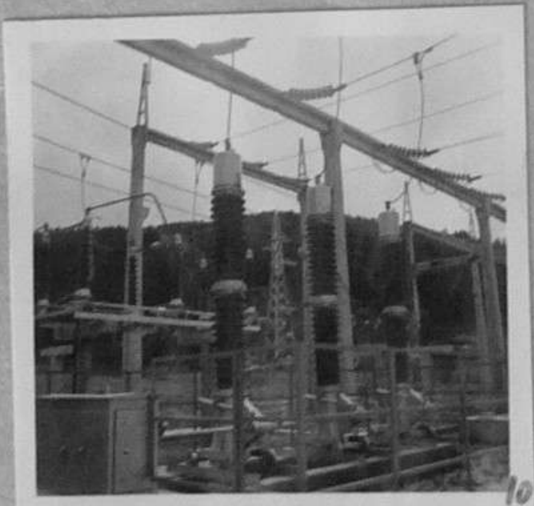
Ел.подстанция Котел. 72-4204-10-Прекъсвач на 110 киловолта.
