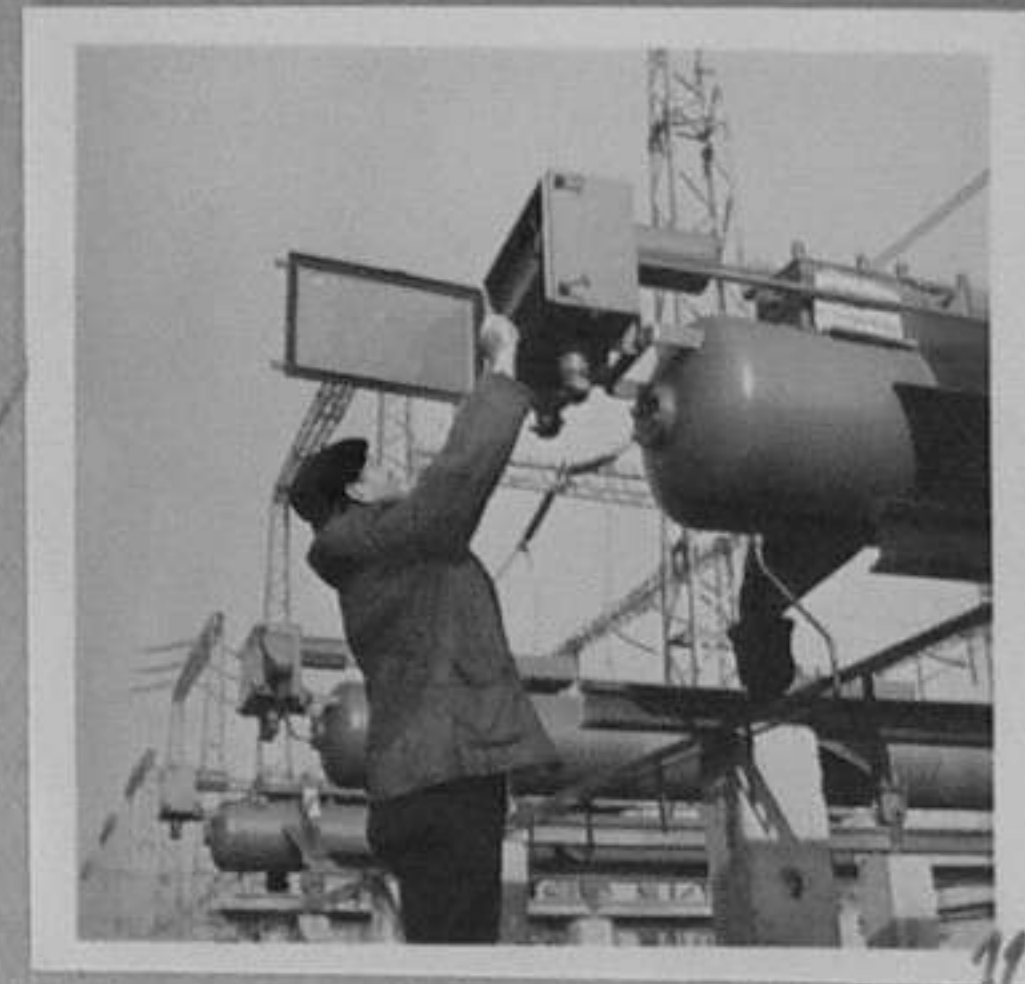
71-668-11-Подстанция "Мизия" от далекопровода "Дружба". /Л.Златков/ ХП
