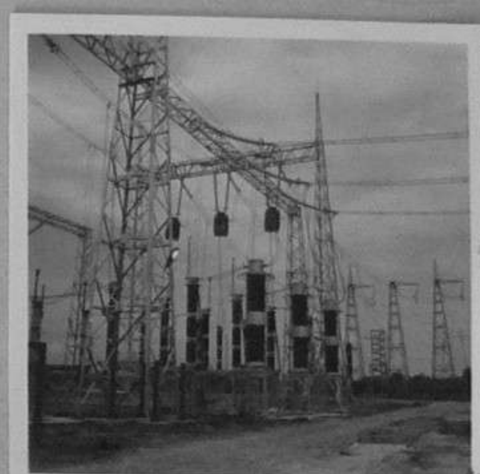
72-4208-10-Изглед от подстанция "Добруджа". /Е.Богоев/МК
