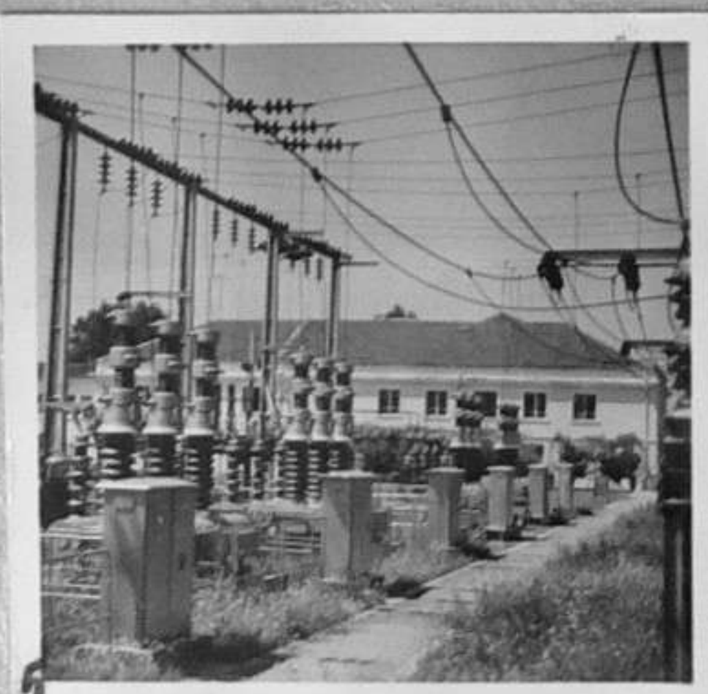
66/2127-5-Подстанция "Ниевдив". /Юскеселиев/ММ
