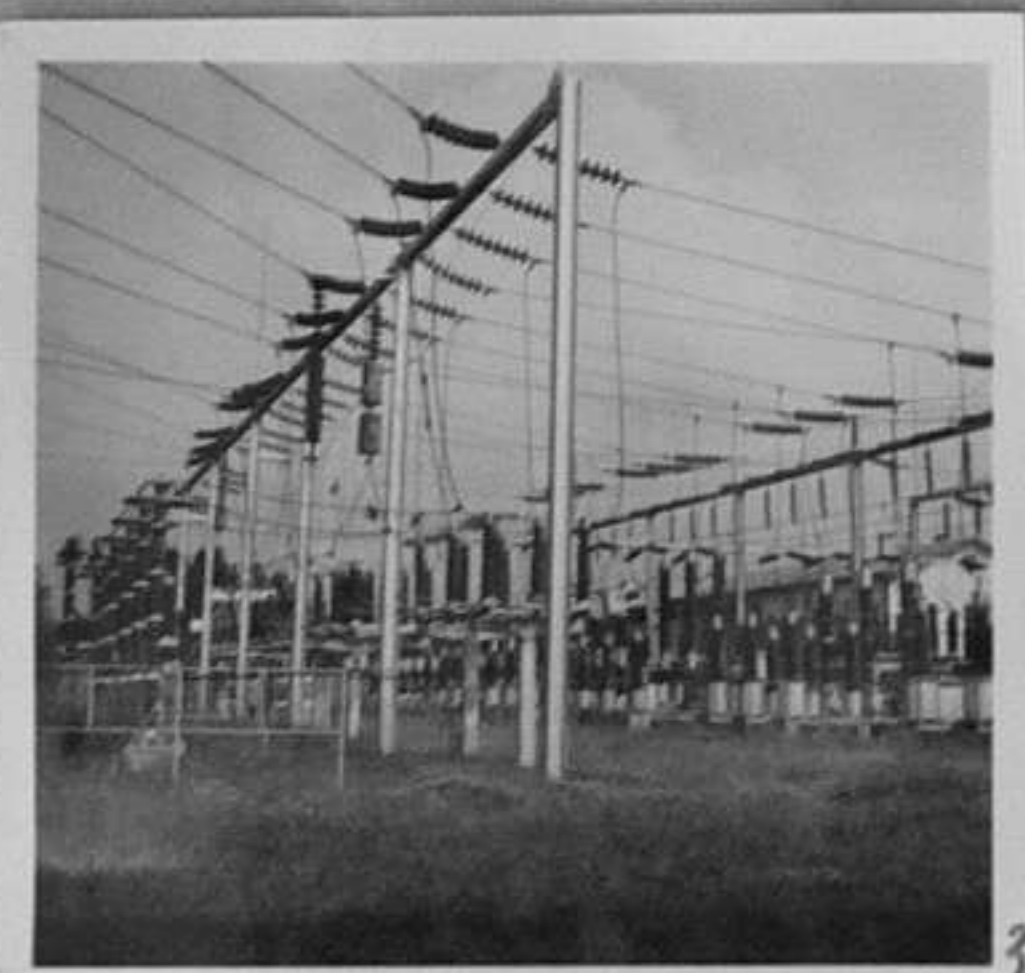
69-3096-3-Ел.подстанция - Мездра. /В.Димитров/ ИК
