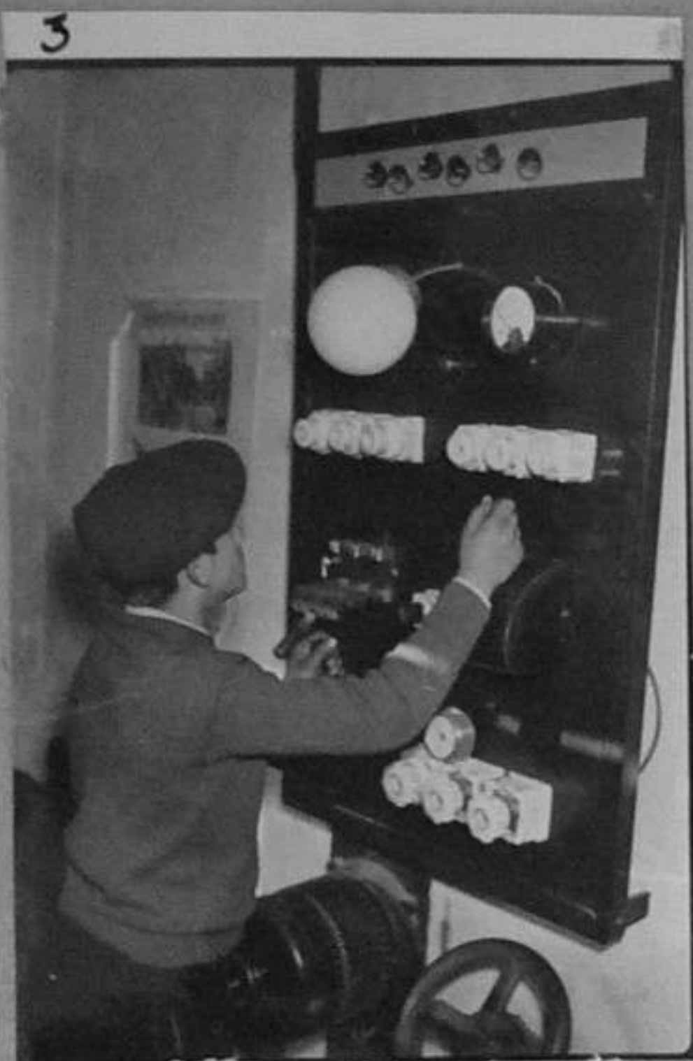
56/3019-3-В електростанцията в ТКЗС "Малина", с. Чифлик, Троянско. /Кожухаров/ ИМ
