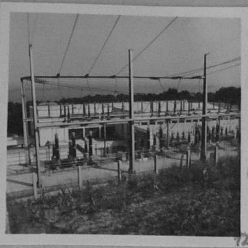
72-4210-12-Откритата уредба на подстанцията. /Е.Богоев/МК
