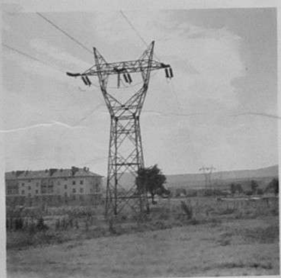
57/2908-8-Далекопроводът "Девня" - Поляновград. /Парушев/
